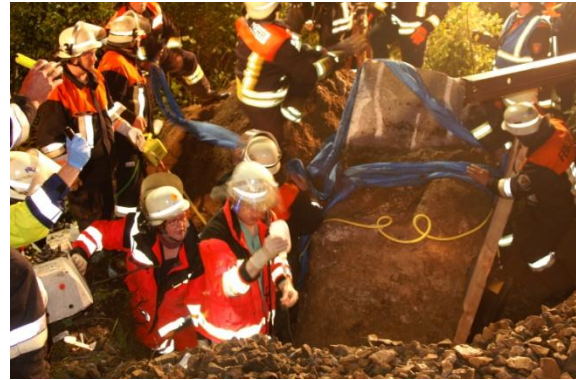
Bild 82: Bergung eines eingeklemmten Bahnarbeiters
