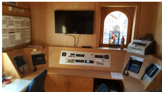
Bild 127: Funkraum im Gerätehaus
